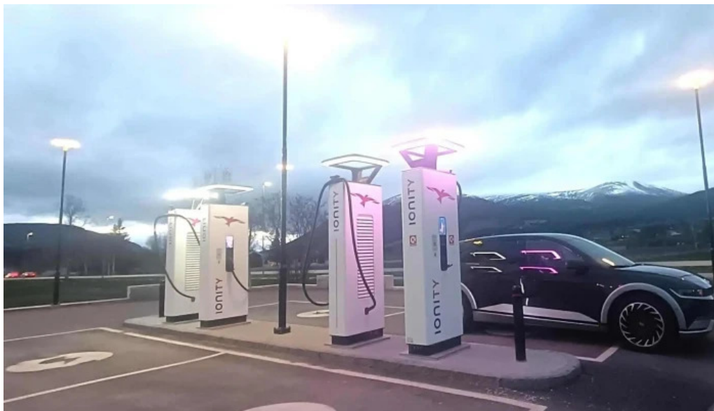
Ionity ladestasjon ladestasjon for elektriske biler
